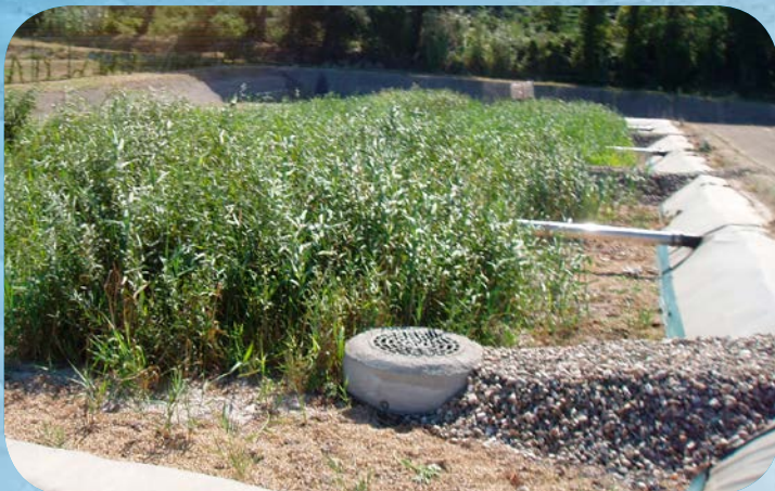
Filter planté de roseaux station d'épuration de Poilhes
