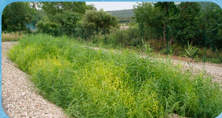
Murles : 2 ème étage filtre planté de roseaux
