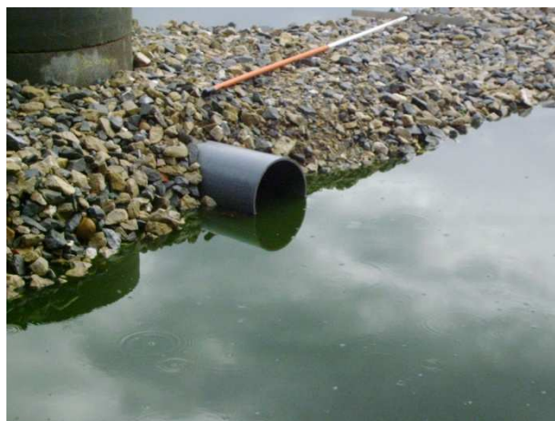
By-pass digue partiellement en charge (juillet 2011)
