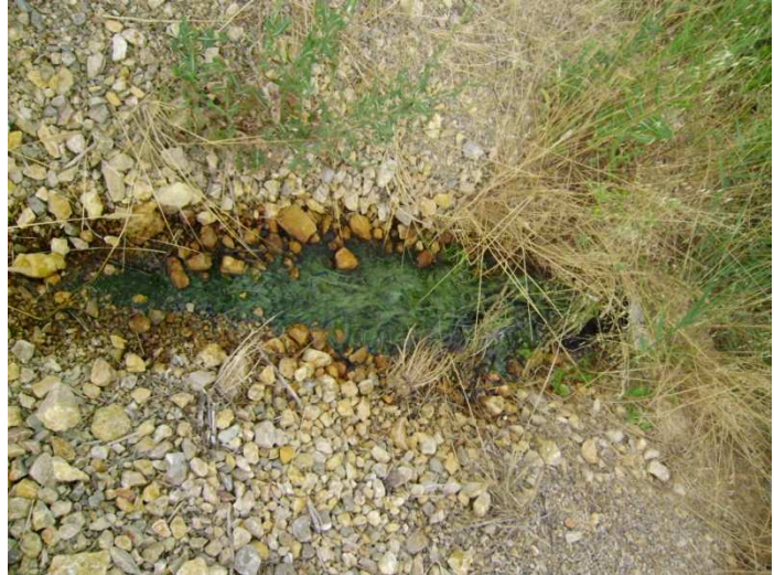
Figure 4 : chenal de sortie reprise hydraulique
