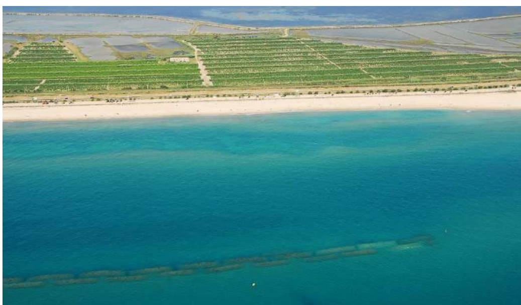
Figure 33 : Vue aérienne du géotube installé à partir de 2013 face au lido de Sète (image aérienne EID/CD34 2018)
