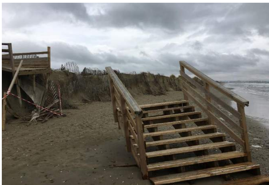
Figure 13 : Dégâts visibles sur la plage du Petit Travers suite à la tempête de mars 2018
