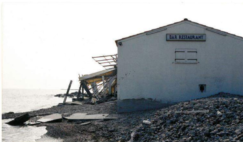
Figure 11 : Dégâts sur la route du lido de Sète (haut) et sur la plage des Aresquiers (bas) suite à la tempête de décembre 1997
