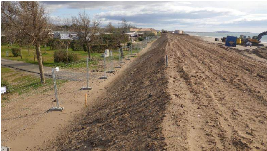
figure 50 : travaux de façonnage du cordon dunaire de Vias ouest, en mars 2015 (photo EID)
