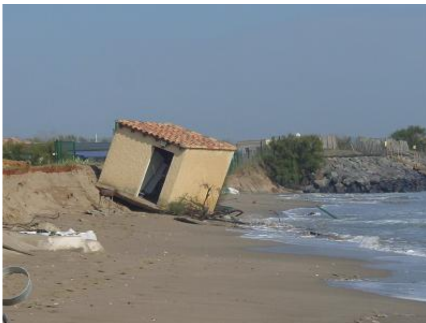
Photo 13 : Dégâts liés au coup de mer sur la plage située entre Sainte Geneviève et la Farinette le 4 Octobre 2010
