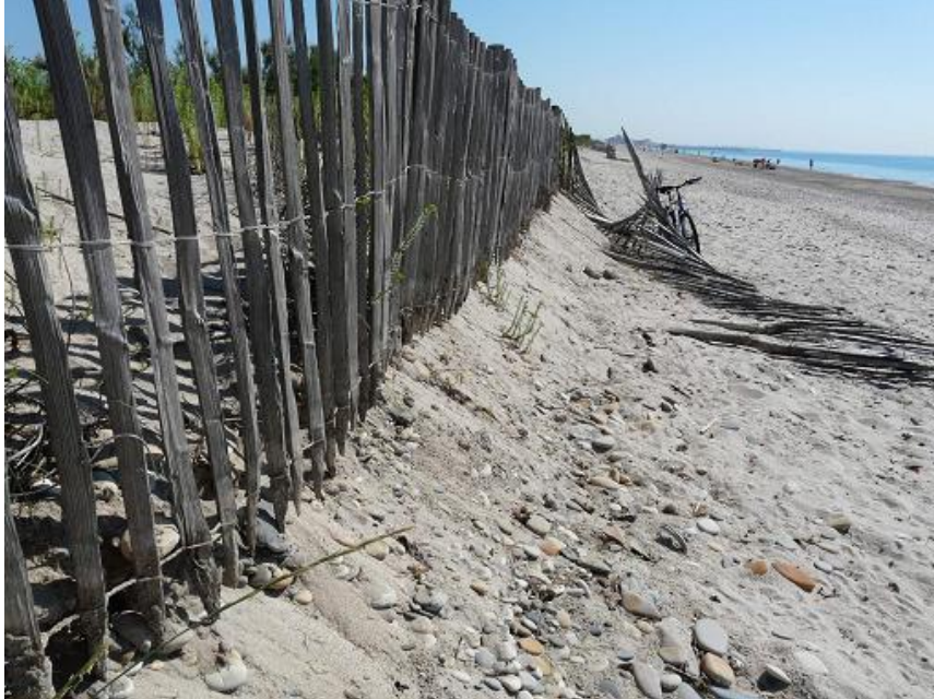
Photo 24 : Dégradation d'une ligne de ganivelle le 8 Juillet 2010
