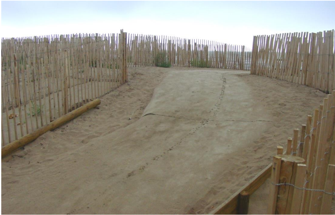
▲ Vue de détail d'un accès piétonnier trans-dunaire dans le secteur des Mouettes. Noter sa grande largeur, et le géotextile apparent, qui ne recouvre pas toute la surface du passage.
