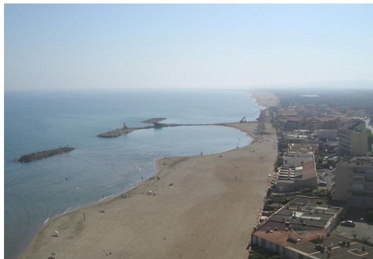
Figure 46. Vue sur les travaux de pose des brise-lames à Valras le 24 Avril 2004. Au niveau des enrochements de fond de plage celle-ci a disparu.
