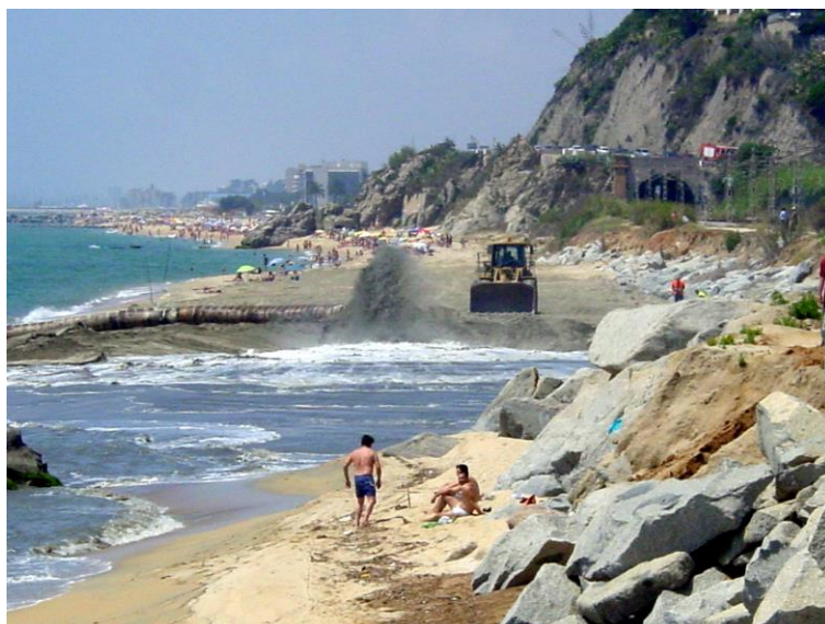
figure 66 : Rechargement de la plage d'Arenys de Mar, au nord de Barcelone (sable dragué au large et refoulé par conduite) (conférence de phase B beachmed-e ; visite de terrain du 30 juin 2007)
