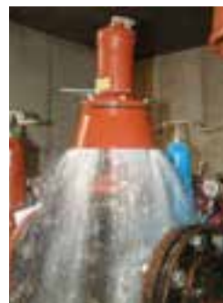
Soupape de décharge en fonctionnement (source : OIEau)
