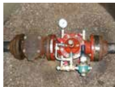
Vanne de régulation de pression (source : OIEau)
