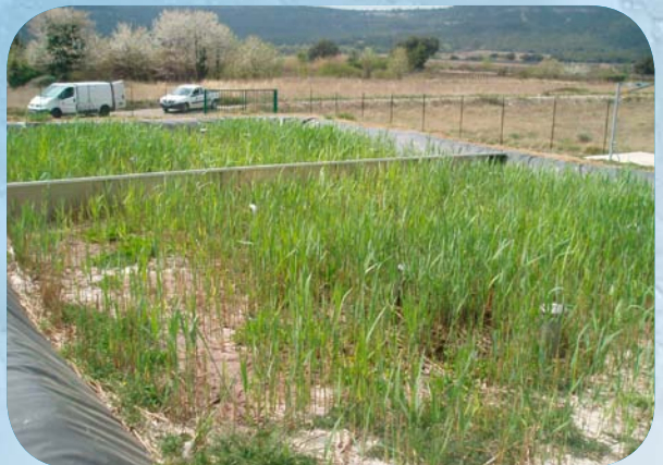
STEP de Claret (Les Embruscalles) : épuration des eaux usées par filtres plantés de roseaux. Photo : F. Chatellier
